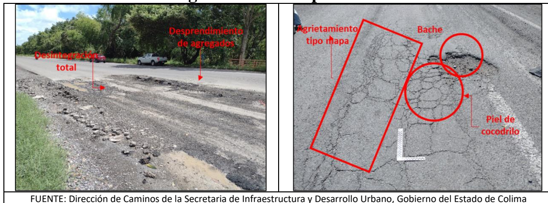
Imagen 3. Fallas en pavimentos
