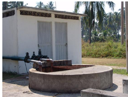
FOTO 28: Carcamo de Bombeo de la Planta de Tratamiento de Aguas Negras de Cuyutlán.
