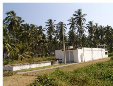
FOTO 27: Planta de Tratamiento de Aguas Negras.
