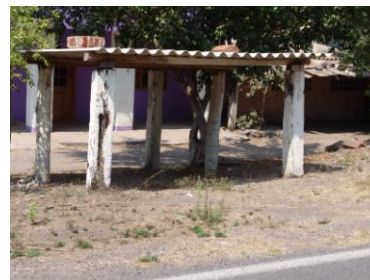
FOTO 24 y 25: Mobiliario Urbano en mal estado de conservación.
